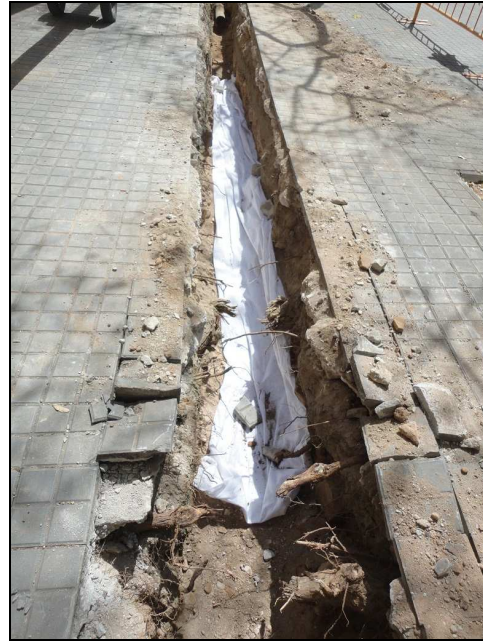
Restes cobertes amb geotèxtil per tal de col·locar el servei d'aigua a sobre.
