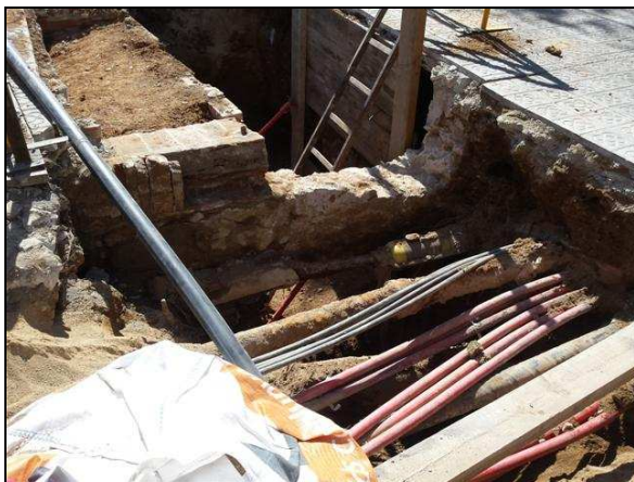
Imatge de la rasa 200 amb la fonamentació i les restes del mur de façana al perfil nord de la rasa.
