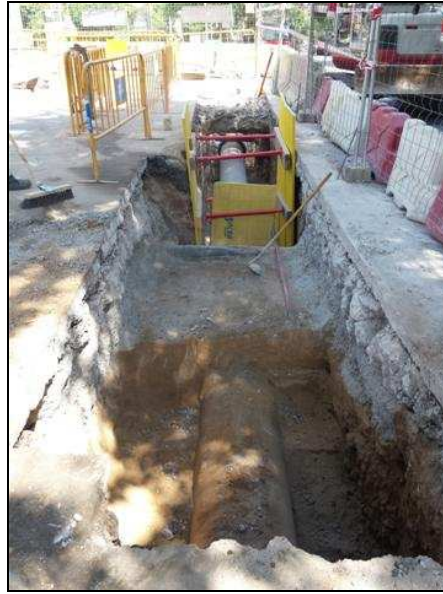
Vista NW de la rasa amb un tram amb el nou tub d'aigua i un altre amb l'antic servei.
